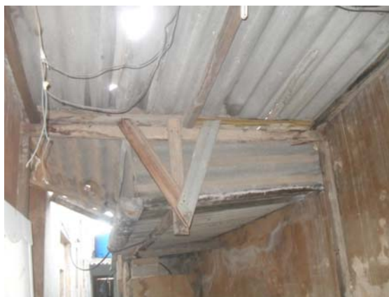
Das renovierungsbedürftige Dach des Gemeindezentrums
