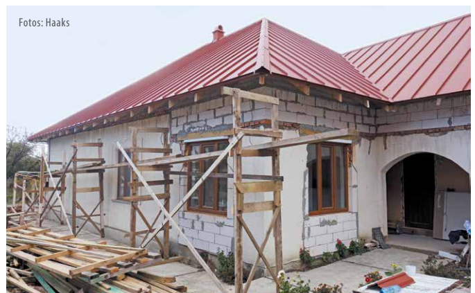
Das GAW unterstützt 2019 die Sanierung und den Ausbau des Gemeindehauses in Bene.
